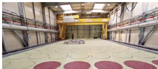
Les déchets MA VL doivent progressivement rejoindre Cedra, nouvelle installation d'entreposage dimensionnée au risque sismique
